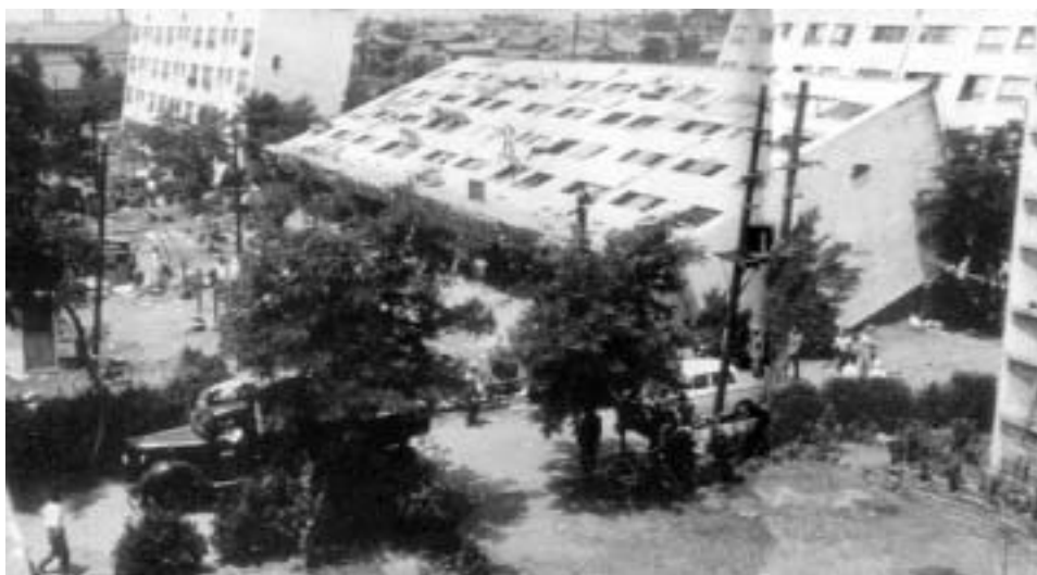
写真 「新潟地震の地盤液状化現象で傾いた壁式構造の県営アパート」
